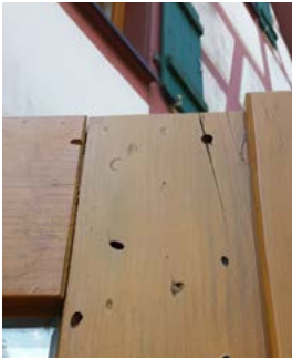
Hausbock & Holzfraß an Scheurentür
